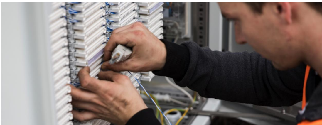
Figuur 20. Werkzaamheden door een monteur in een VDSL-straatkast (bron: [orsatel.nl] )
