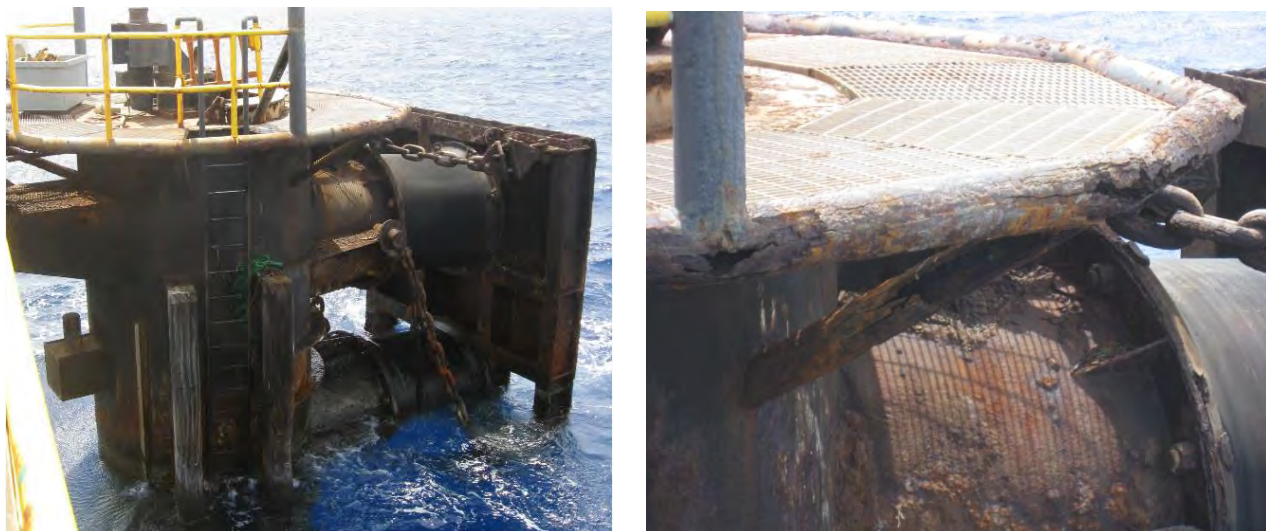
Figuur 3-4: Fenderpaal met fenderconstructie / Bordes fenderpaal met gecorrodeerde ondersteuningsbalken
