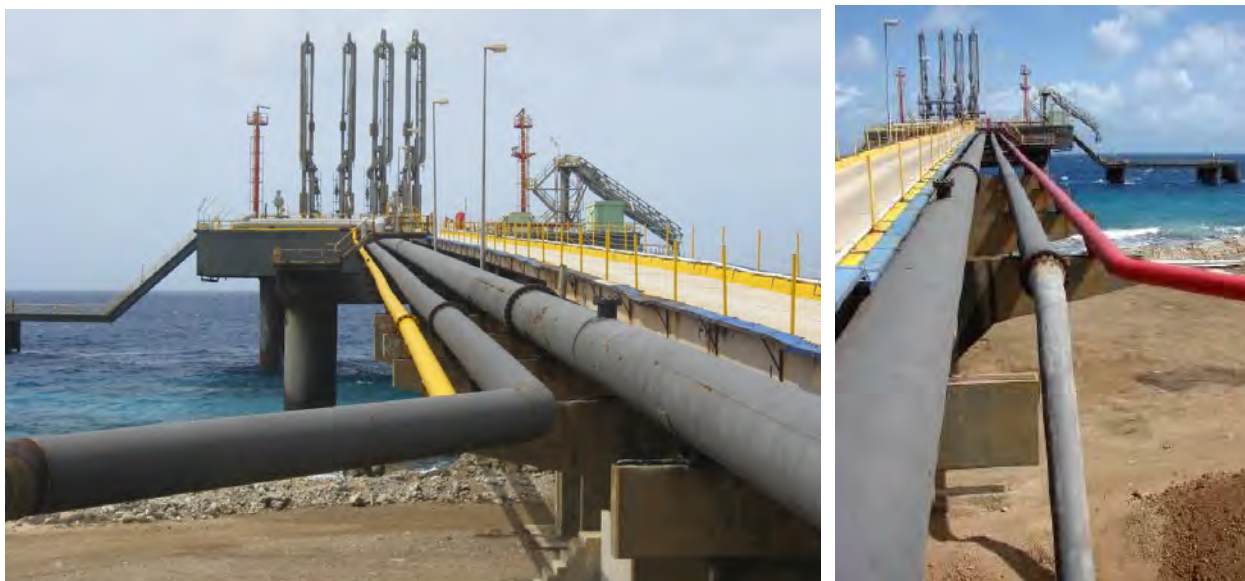
Figuur 3-8: Productleidingen op de jetty
