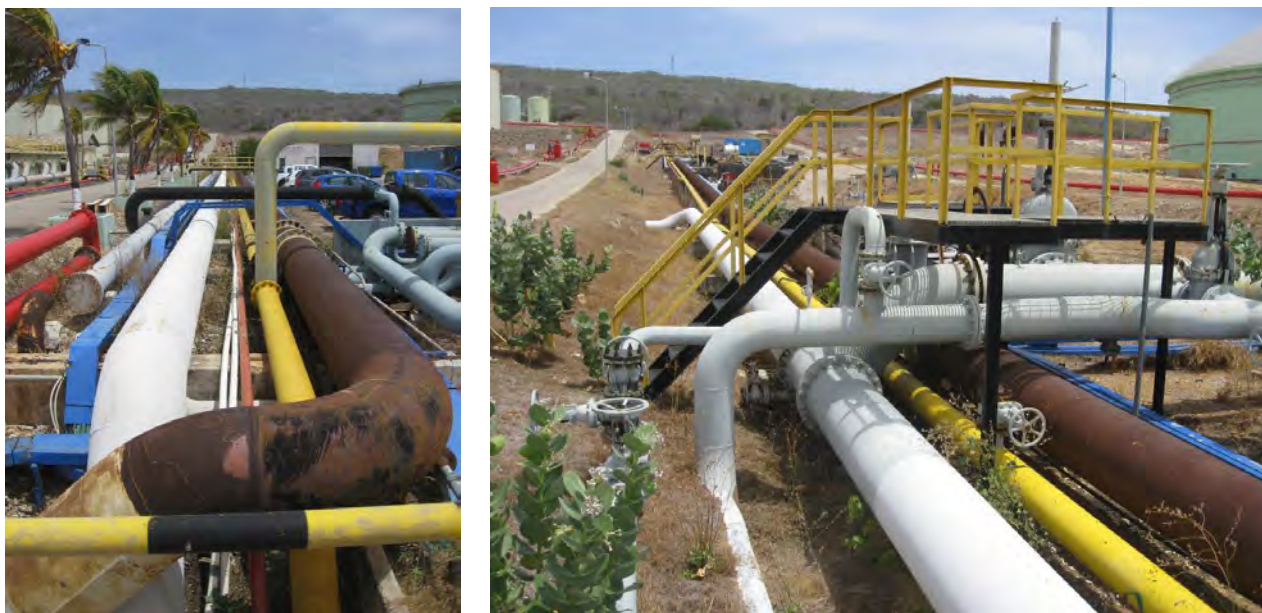
Figuur 3-10: Productleidingen naar TK1910
