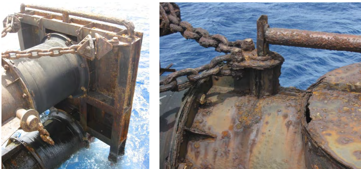
Figuur 3-5: Fenderplaat met gebroken ketting / Zware corrosie aan kettingen
