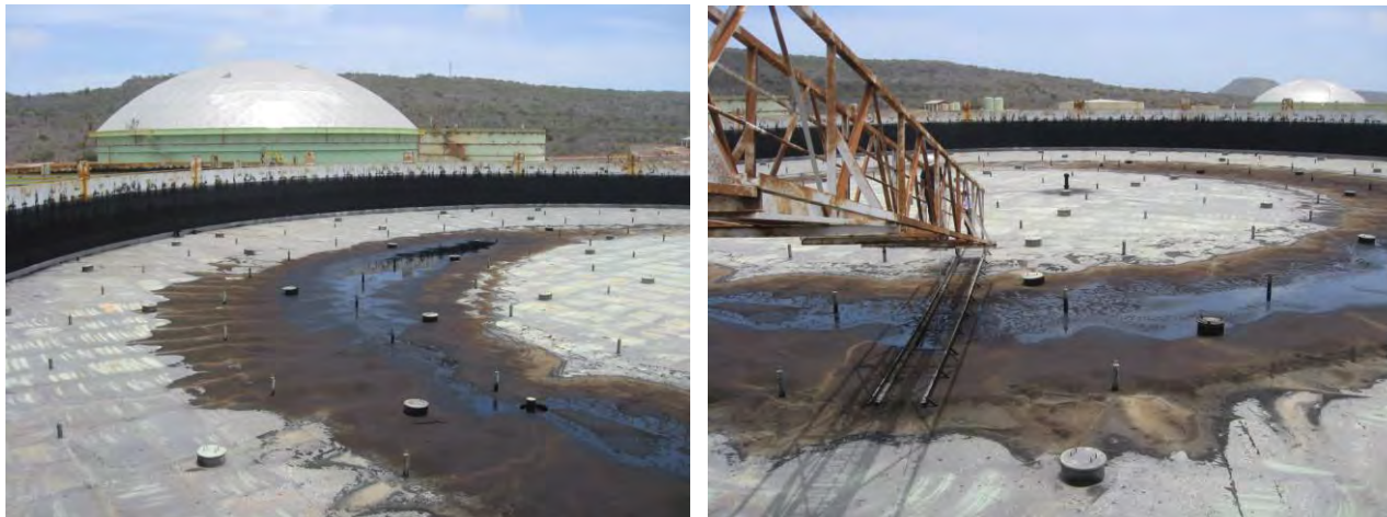
Figuur 4-1: Lekkage aan het drijvend dak van tank TK1934 met op de achtergrond tank TK1933
