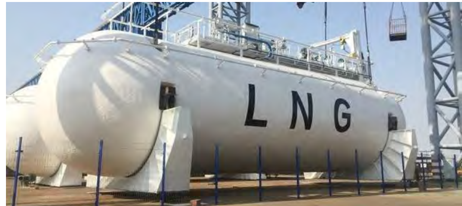
Voorbeeld van een LNG storage tank op het land, die andere specificaties vereist dan diesel- of stookolie-tanks
